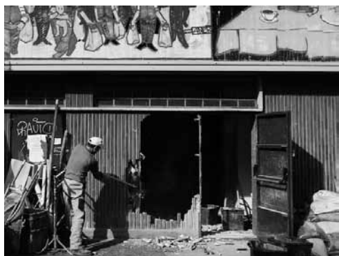
Abbattimento del muro di separazione del mercato comunale di via Odazio, verso il parco
